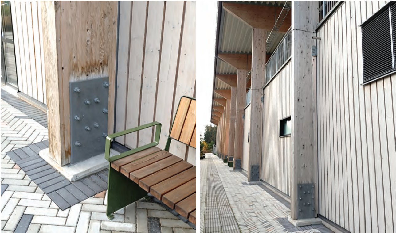
Bild 98. Bärverk i korslimmat trä. Foton: Yvonne Egnér/Boverket.
