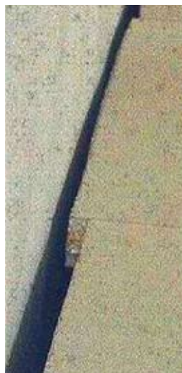
Flytande golv ska inte ligga emot vägg.
