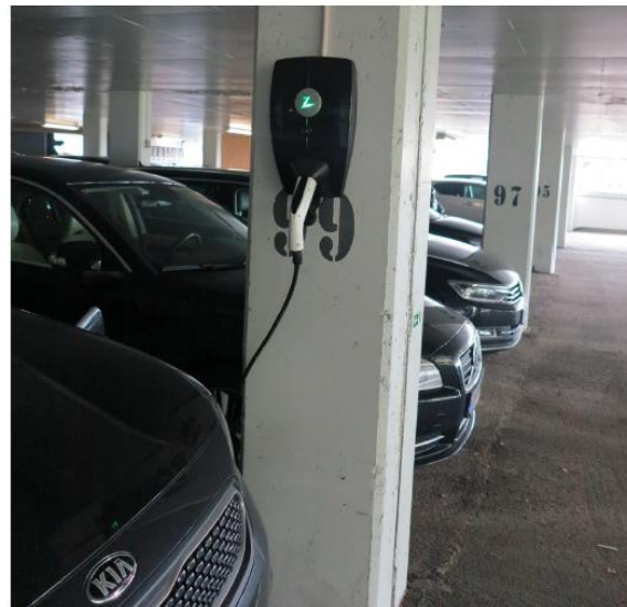
Lading av elbil i parkeringsgarasje
