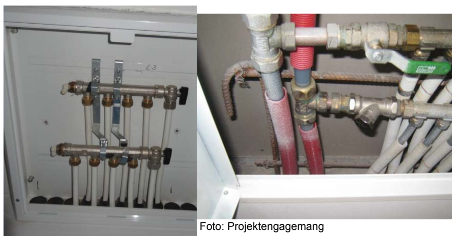
Figur 3 Exempel på centralt dragna värmestammar med fördelarskåp, ett där mätare kan installeras och ett utan plats för installation av värmemätare.
