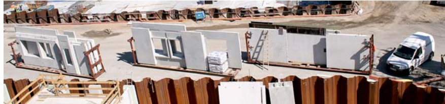
Figur 12 Leveranserna av de prefabricerade betongelementen visade sig svåra att anpassa till projektets bokningssystem för leveranser.
