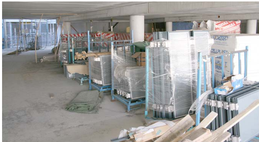
Figur 11 Varje entreprenör hade sitt eget område i källaren där material förvarades inför inbyggnadsarbetet.
