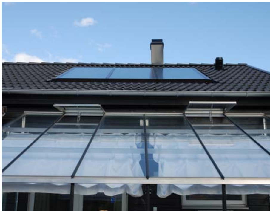
I Villa Trift 3.0 används aktiv solenergi genom sju kvadratmeter solfångare på taket.
