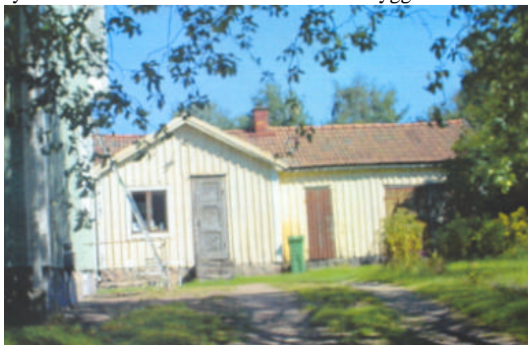
Västra Hylte 1:38 Takteglat fick bytas mot tegelimiterande plåt trots varsamhetsbestämmelser i detaljplan. Foto: Pontus Swahn, Bygg- och miljöförvaltningen Hylte kommun
